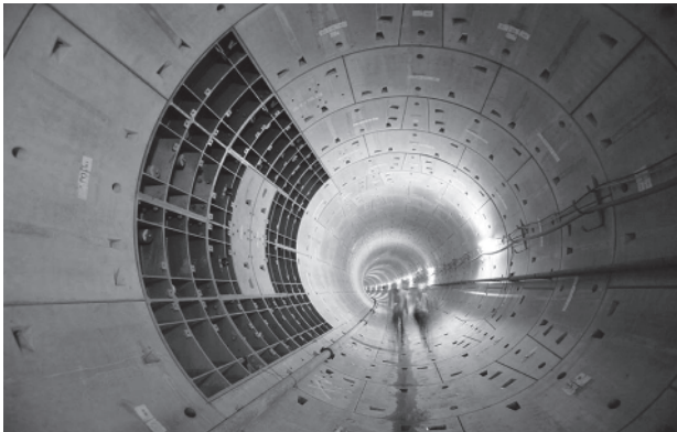
Bild 16. Stahlübbings um eine Querschlagöffnung
