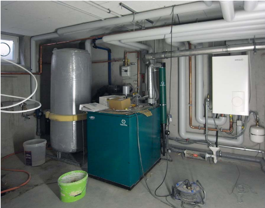
Abb. 6.3: Das Blockheizkraftwerk im Keller
