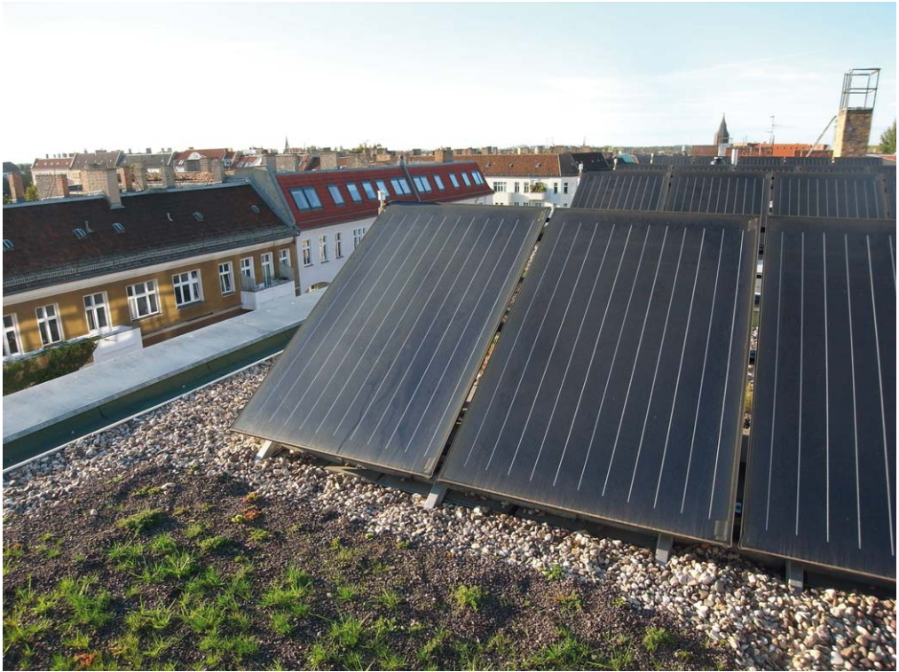
Abb. 6.2: Thermische Solaranlage zur Warmwasserbereitung
