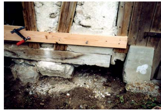
Der bestehende Schwellenbalken aus Kiefernholz ist nach ca. 100 Jahren durch Feuchtigkeit geschädigt [A].
